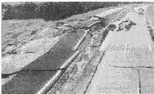
図-1 新潟県中越地震での道路損壊
